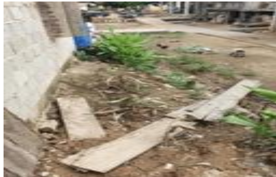
Gambar 2. Tidak dilengkapi Saluran Pembuangan yang Baik
