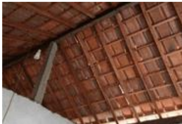
Gambar 1. Rangkap Atap Tidak Terpasang Lengkap
